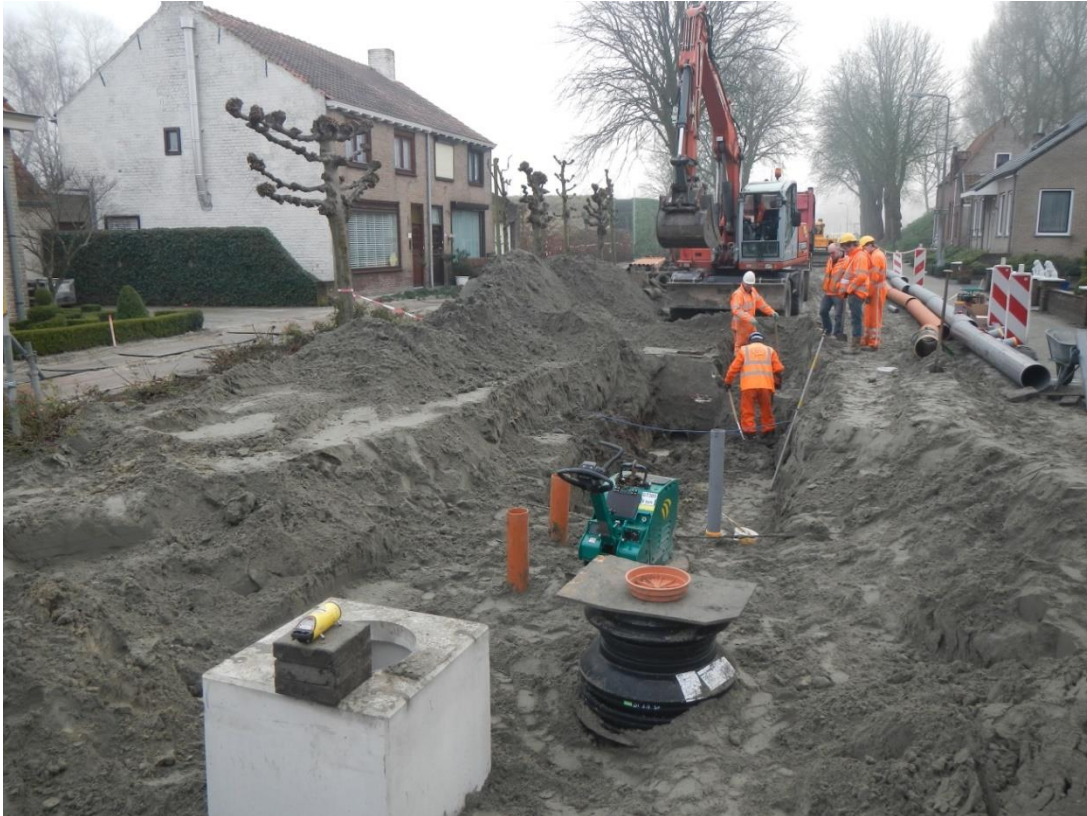
Afbeelding 12 Zicht vanuit noordelijke richting op de archeologische begeleiding van de rioleringswerken tijdens veldwerkfase 2. Het opnieuw ontgraven van het aangebrachte cunet belemmert niet alleen de zichtbaarheid van de sporen, maar ook de algemene voortgang van de werken.
